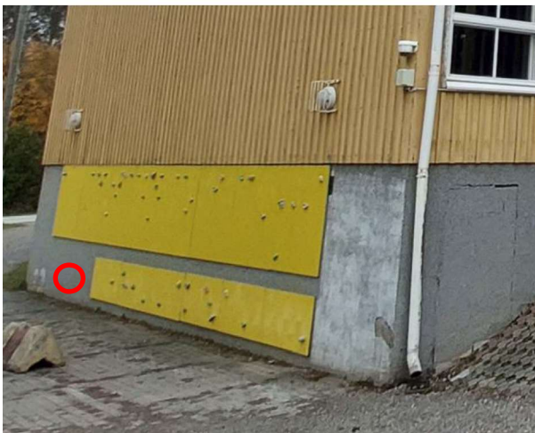
Kuva 24. Kuvassa oikealla näkyy muuramalla ummistettu wc-tilaan johtava ovi. Punaisen ympyrän kohdalle tehtiin rakenneavaus sokkelin läpi.
