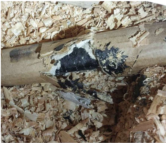
Kuva 14. Asbestia sisältävä putkieriste rakenneavauksen RA1-AP kautta kuvattuna.
