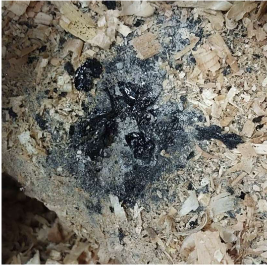
Kuva 13. Asbestia sisältävä bitumisively sokkelin päällä MN1.
