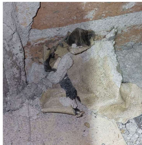
Kuva 21. Bitumoitu valupaperi näyttämön alapuolisessa tuolivarastossa.
