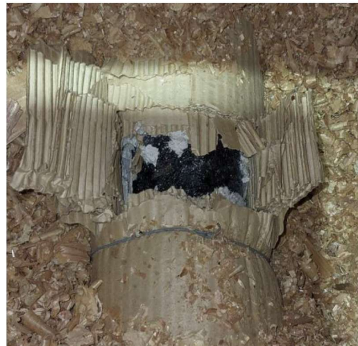
Kuva 15. Asbestia sisältävä putkieriste rakenneavauksen RA2-AP kautta kuvattuna.
