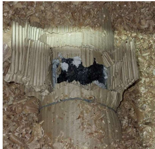
Kuva 15. Asbestia sisältävä putkieriste rakenneavauksen RA2-AP kautta kuvattuna.
