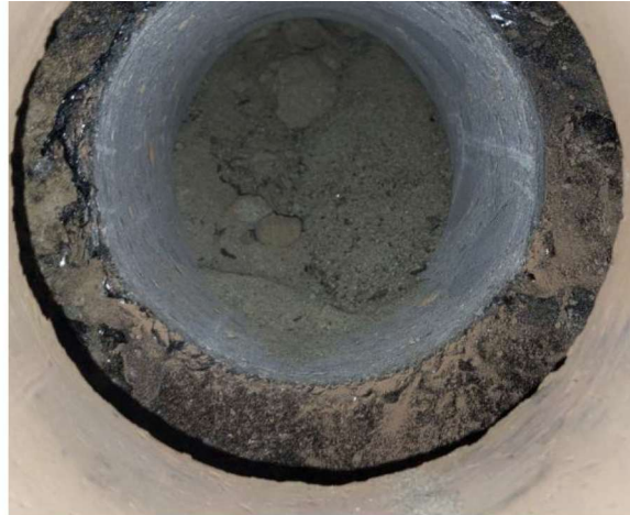
Kuva 19. Maanvastaisen seinän rakenneavaus RA6-MV. Betonin sisäpinnassa on bitumisively, joka sisältää PAH-yhdisteitä yli vaarallisen jätteen pitoisuusrajojen.
