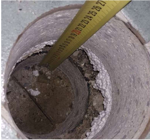
Kuva 18. Alapohjan rakenneavaus RA4. Alemman laatan yläpinnassa on bitumisively, joka sisältää PAH-yhdisteitä yli vaarallisen jätteen pitoisuusrajojen.
