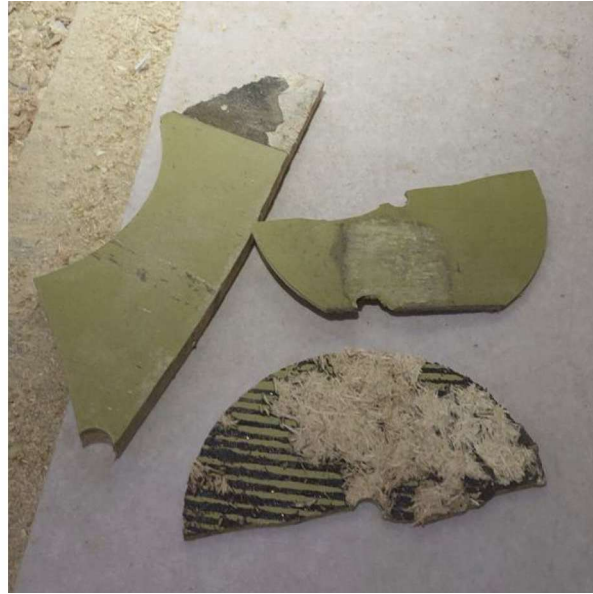
Kuva 17. Vihreän muovimaton musta kiinnitysliima sisältää asbestia.
