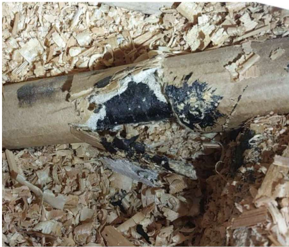
Kuva 14. Asbestia sisältävä putkieriste rakenneavauksen RA1-AP kautta kuvattuna.
