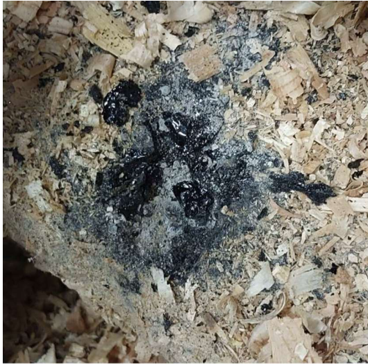
Kuva 13. Asbestia sisältävä bitumisively sokkelin päällä MN1.
