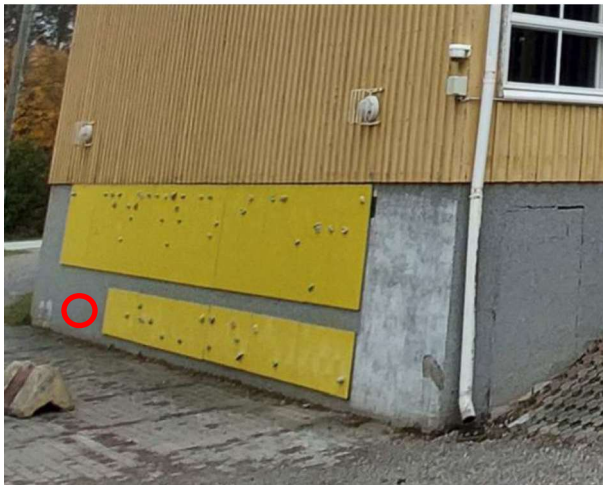
Kuva 24. Kuvassa oikealla näkyy muuraamalla ummistettu wc-tilaan johtava ovi. Punaisen ympyrän kohdalle tehtiin rakenneavaus sokkelin läpi.
