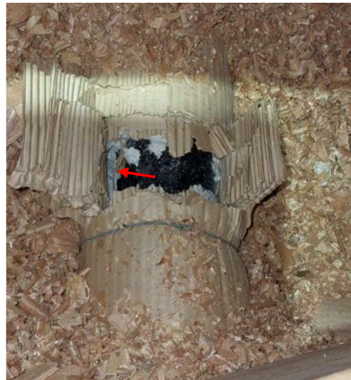
Kuva 7. Salin lattiarakenteen koolaustilassa on asbestipitoisia putkieristeitä. Asbestipitoinen vaaleanharmaa massa osoitettu nuolella.
