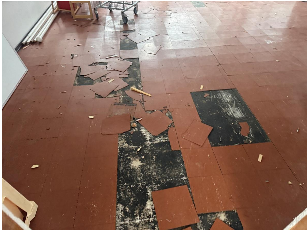
Kuva 1. Asbestipitoista mustaa liimaa punaisten vinyylilaattojen alla.
