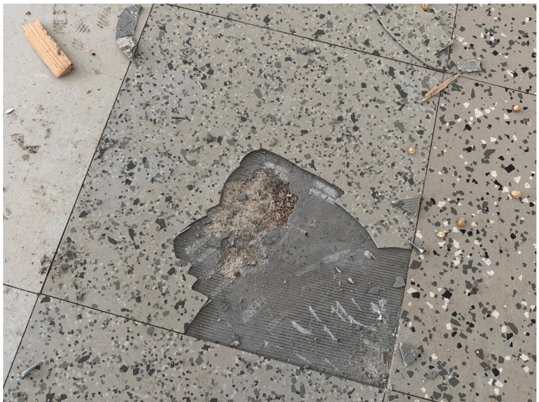
Kuva 3. Asbestipitoista mustaa liimaa sirotekuviollisten vinyylilaattojen ja tasoitteen alla.
