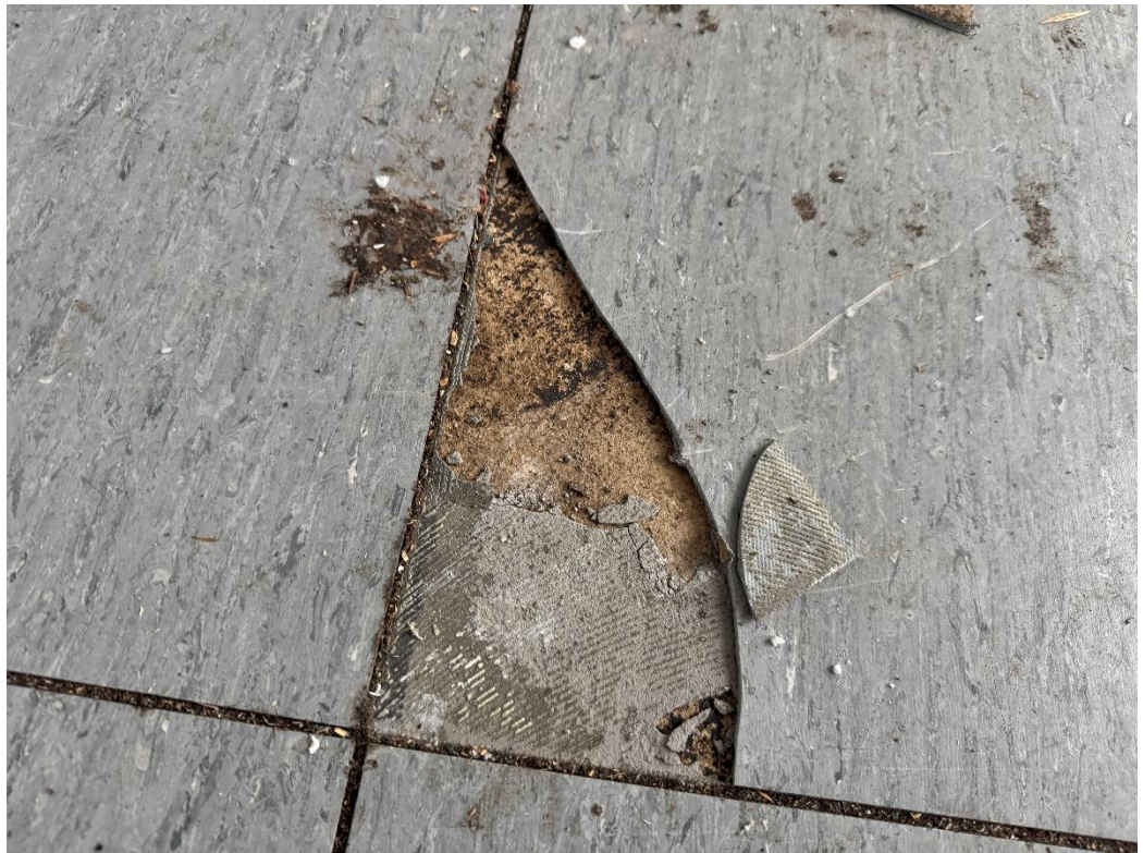
Kuva 2. Asbestipitoista mustaa liimaa harmaiden vinyylilaattojen ja tasoitteen alla.
