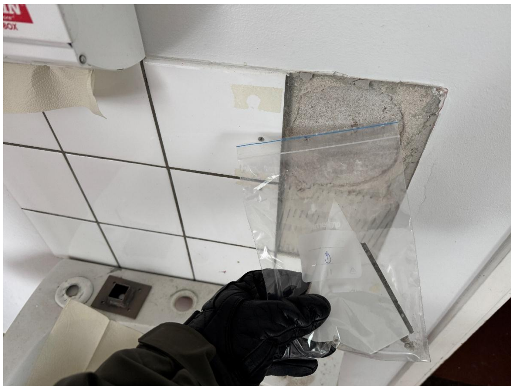
Kuva 4. Seinälaatta valkoinen 150x150 +tumma sauma +kiinnityslaasti (näyte 9) sisältää asbestia. Asbesti on laatan kiinnityslaastin rakenteessa.
