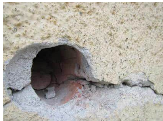
Kuva 132, Esimerkki eteläsiiven julkisivulla tyyppillisesti esiintyvistä halkeamista. Kualähde: Kiwa Inspecta, 2022.
