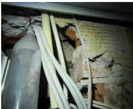
Kuva 125, 2. kerroksen kirjastotilassa sijaitseva nousukotelo.
