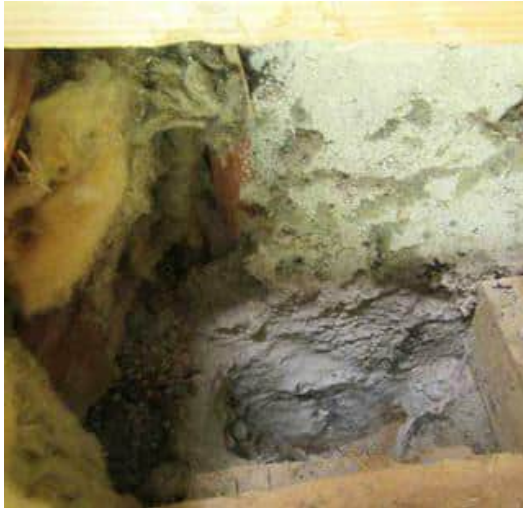
Kuva 128, Alapohjan liittymä ei ole tiivis. Kuvälähde: Kiwa Inspecta, 2022.
