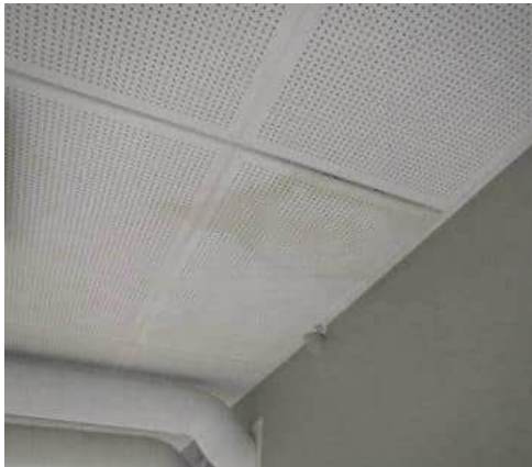
Kuva 133, Kuvassa silmin havaittava kosteusjälki 2. kerroksen alakattolevyssä. Kuvälähde: Kiwa Inspecta, 2022.
