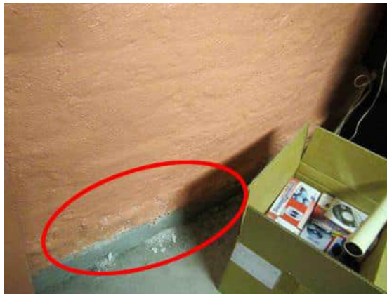
Kuva 129, Perusmuurauksen kuorimuurauksen alaosassa on kosteusvauriota. Kuva eteläpäädytä Jaskan Baarista. Kuvälähde: Kiwa Inspecta, 2022.
