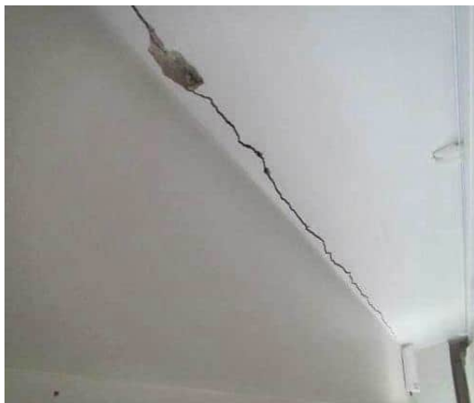
Kuva 121, Ulkoseinän ja yläpohjarakenteen liittymässä halkeama. Kuvälähde: Kiwa Inspecta, 2022.
