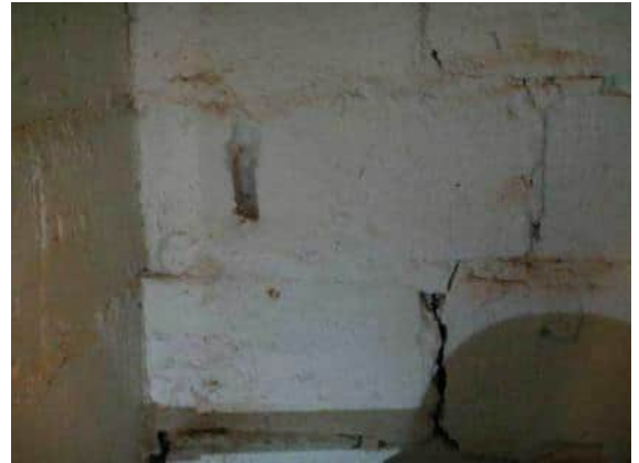
Kuva 130, Voimistelusalin varastotilassa kosteus-sulkusivelyä näkyvissä. Tilassa voimakas PAH-yhdisteiden haju. Kuvälähde: Kiwa Inspecta, 2022.
