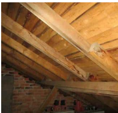
Kuva 136, Rakennuksen keskiosalla havaittiin kosteusjälkiä. Kuvälähde: Kiwa Inspecta, 2022.
