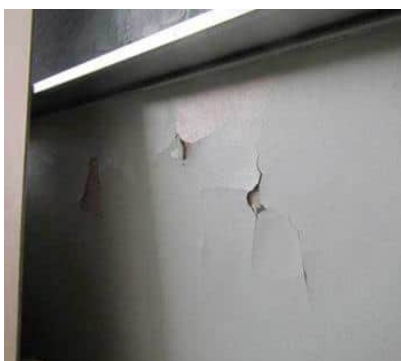
Kuva 134, Seinäpinnoitteessa havaittiin halkeamia. Kuvälähde: Kiwa Inspecta, 2022.
