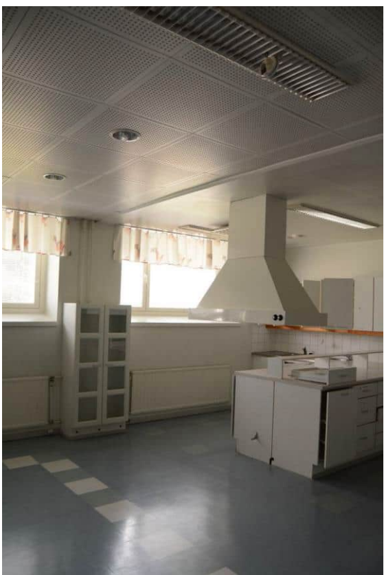
Kuva 116, Tämä eteläsiiven kotitalousluokka ei ole sisäilmaongelmien vuoksi enää käytössä.
