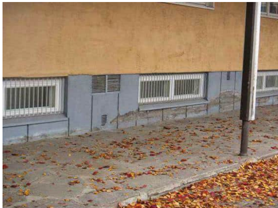
Kuva 119, Idän puoleisen julkisivun perusmuurissa kosteuden aiheuttamia vaurioita. Kuvälähde: Kiwa Inspecta, 2022.
