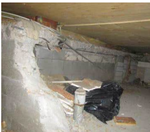
Kuva 127, Näyttämön alla on osittain purettu vanhat WC-tilat, joihin kulku on ollut ulkokautta.
