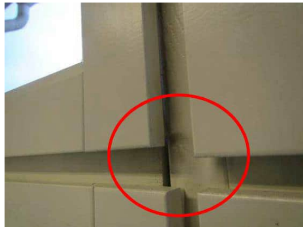
Kuva 122, Ikkunapuitteen tiivistevuotoa ja karmivuotoa. Kuvälähde: Kiwa inspecta, 2022.
