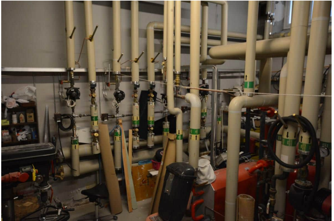
Kuva 100, Rakennuksen keskiosan 0.kerrokseen sijoittuu lämmönjakuhuone.
