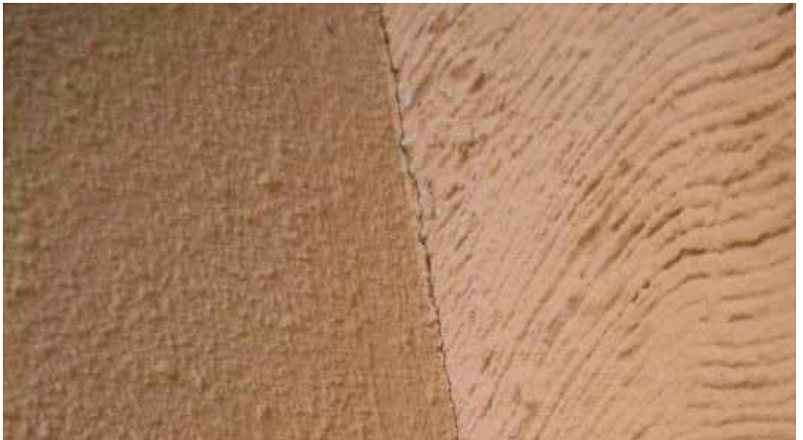
Kuva 42, Kuvassa vasemmalla vuoden 2003 laajennuksen uutta rappauspintaa ja oikealla alkuperäistä rappausta.
