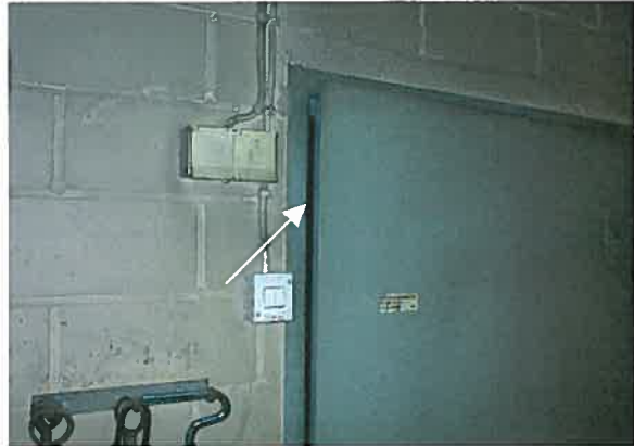
Palo-ovi öljysäiliötilaan ei sulkeudu
