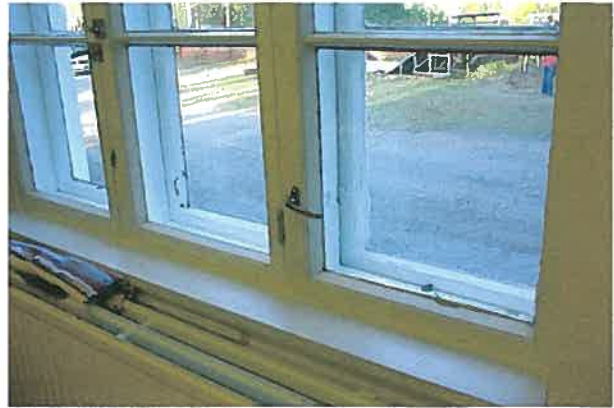
Ikkunat tulisi uusia lähivuosina
