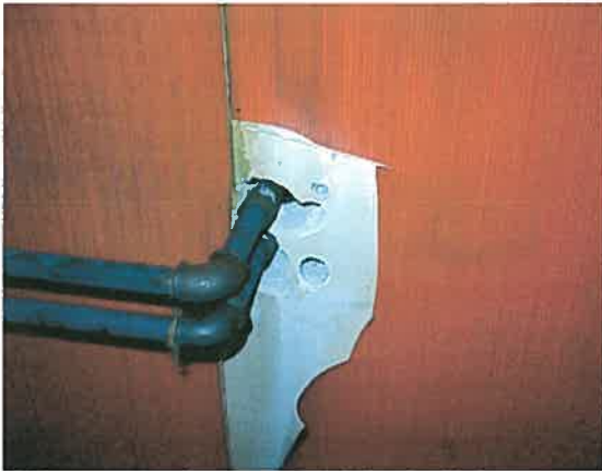
WC 1:een menevien putkien läpiviennit tiivistämättä. Seurauksena öljyn haju WC:ssä.
