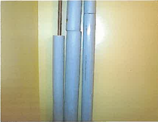
WC- tilassa on käyttövesiputkien eristeet irti
