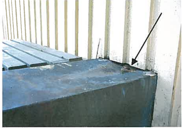
Savupiipun yhdyskanava tulisi pellittää siten, ettei vesi valu seinän sisään
